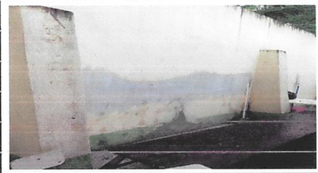
Foto 3: Muro perimetral presenta problemas de humedad y salitre.
